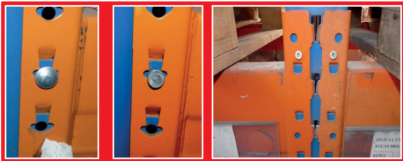
Sworznie zabezpieczające – niewłaściwy rodzaj.
