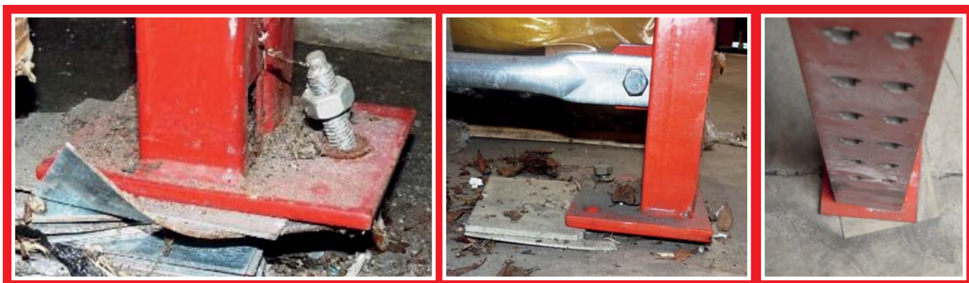
Mocowanie do podłoża – uszkodzone lub brak mocowania.
