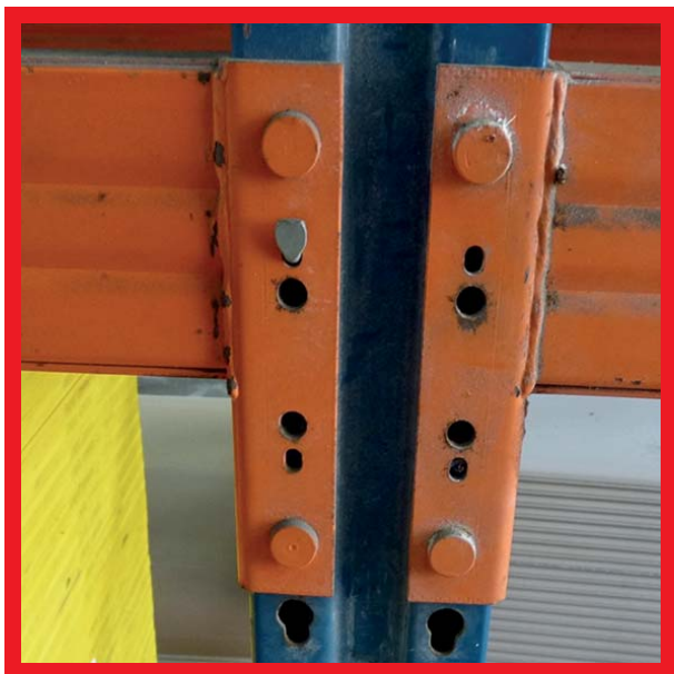
Brak sworzni zabezpieczających.
